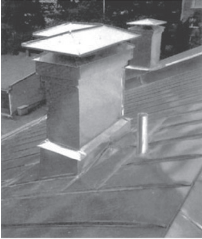
Korstna sademekatus. Viiluplekide püstvaltsid on erinevatel viiudel nihutatud.
